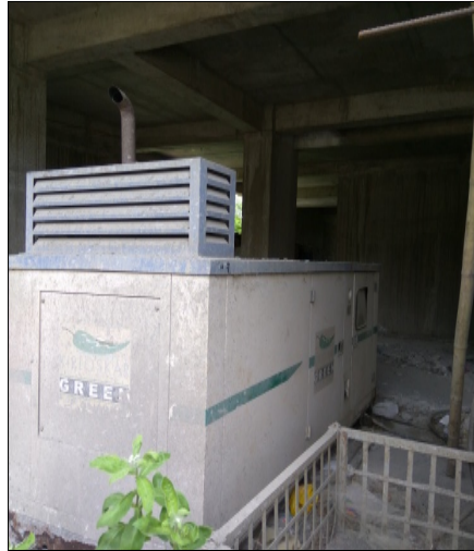
DG Sets on site : 63 KVA
